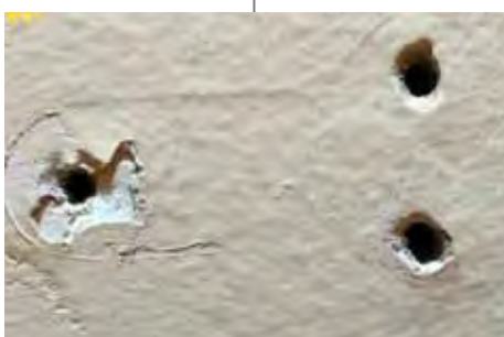
Danni al "cappotto" da errate installazioni.
